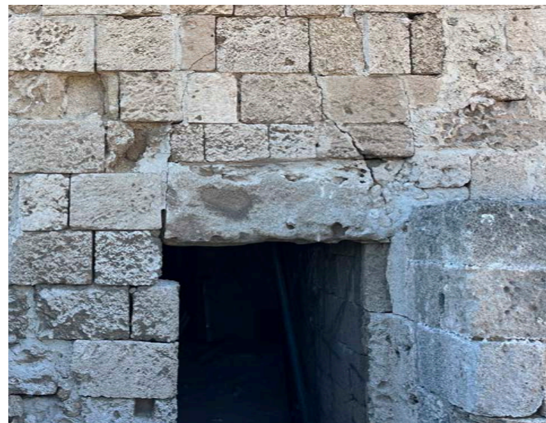
Εικ 12Α. Ρηγματωμένο πρέκι προς αποκατάσταση
